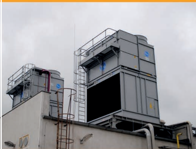
Výparníky na střeše strojovny obsahující amoniak.
